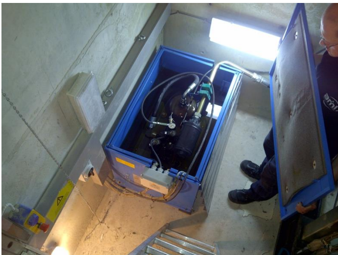
hydraulisch aggregaat in de schachtput
