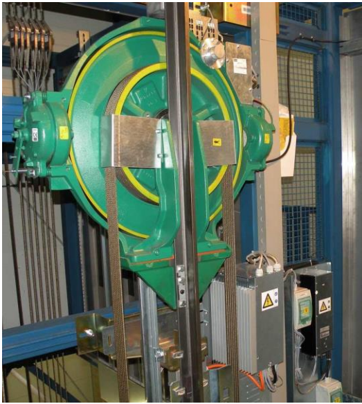
tractiemachine boven in de schacht
